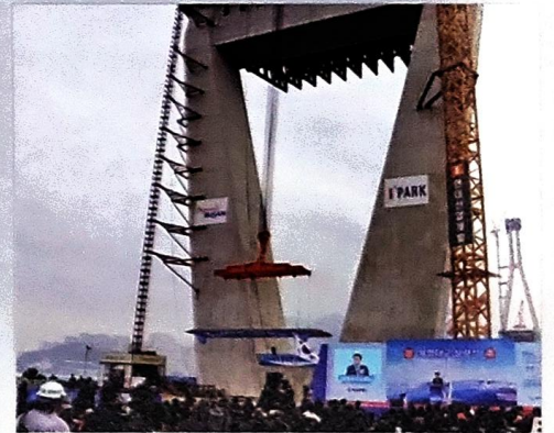
▲부산 남구 감만동과 영도구 청학동을 바다 위로 잇는 북항대교가 지난 28일 상판 상량식을 갖고, 다리 모습을 갖추기 시작했다
